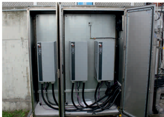
Je ein Umrichter steuert die Drehzahl der drei Kühlwasserpumpen.
