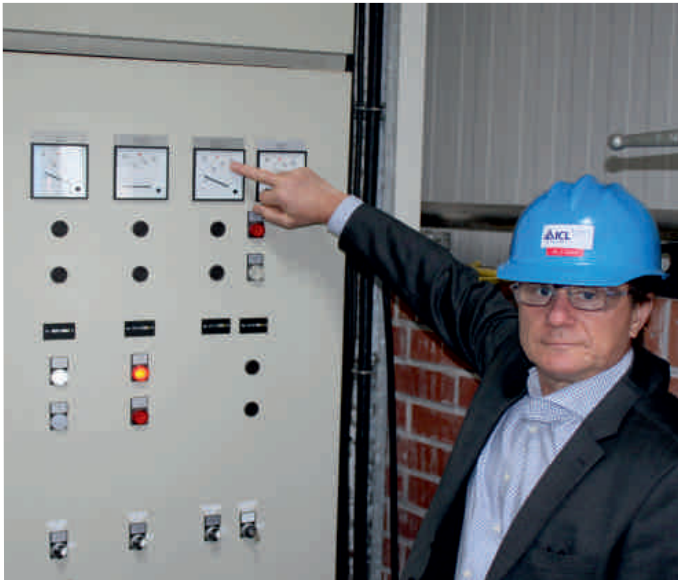
Dr. Ing. Jürgen K. Seifert: „Die Stromaufnahme der Motoren zeigt, dass die Pumpen sehr energiesparend arbeiten.“
