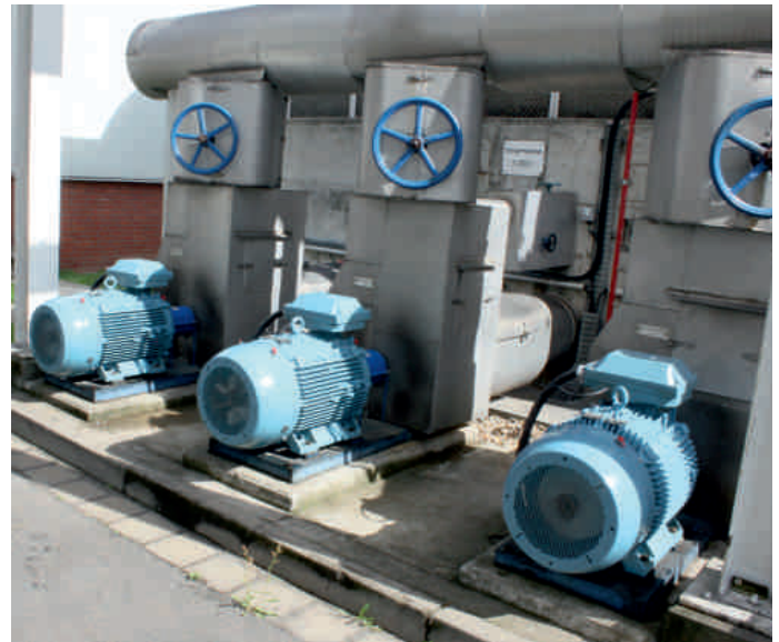
Die drei Allweiler® Kühlwasserpumpen der Baureihe NT. Fördermenge 360 m 3 /h, max. Förderhöhe 52 m.
