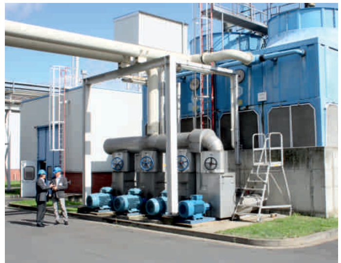
Der zentrale Kühlturm. Die vierte Pumpe ganz rechts dient als Reservepumpe und ist nicht in die automatische Regelung einbezogen.
